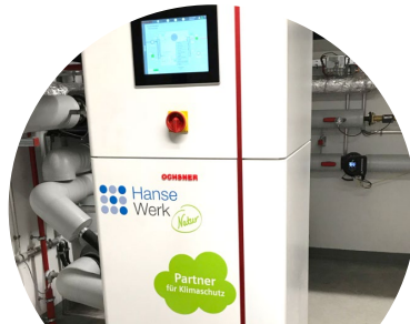
Kombi Fernwärme- Rücklauf und Wärmepumpe
